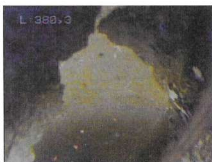
Trou dans le tubage
